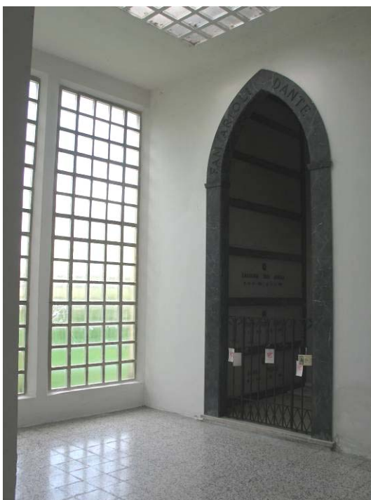
Foto n°8c. Vista dell'angolo nord ovest della galleria porticata chiusa del cimitero. L'ampliamento programmato sarà ubicato nell'area retrostante la vetrata e sarà direttamente collegato mediante la sua demolizione.
